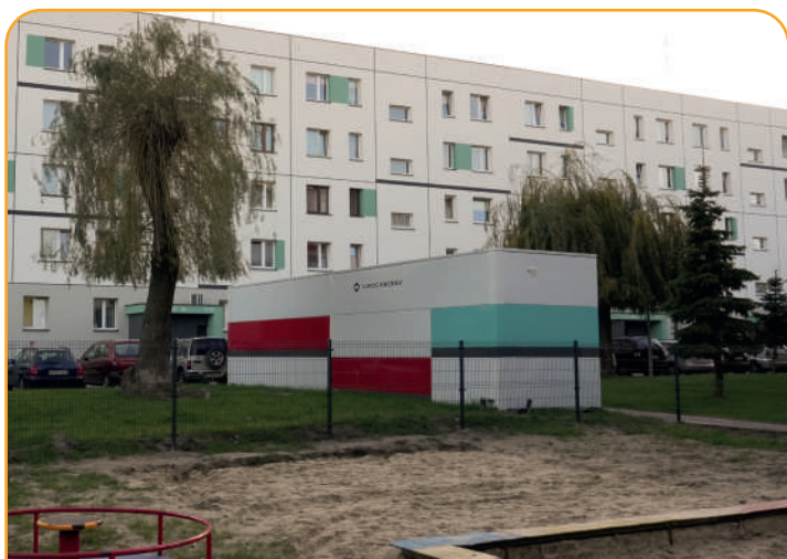
Zwoleń ul. Wojska Polskiego 38 zainstalowana moc 180 kW, ogrzewa 3 500 m 2
